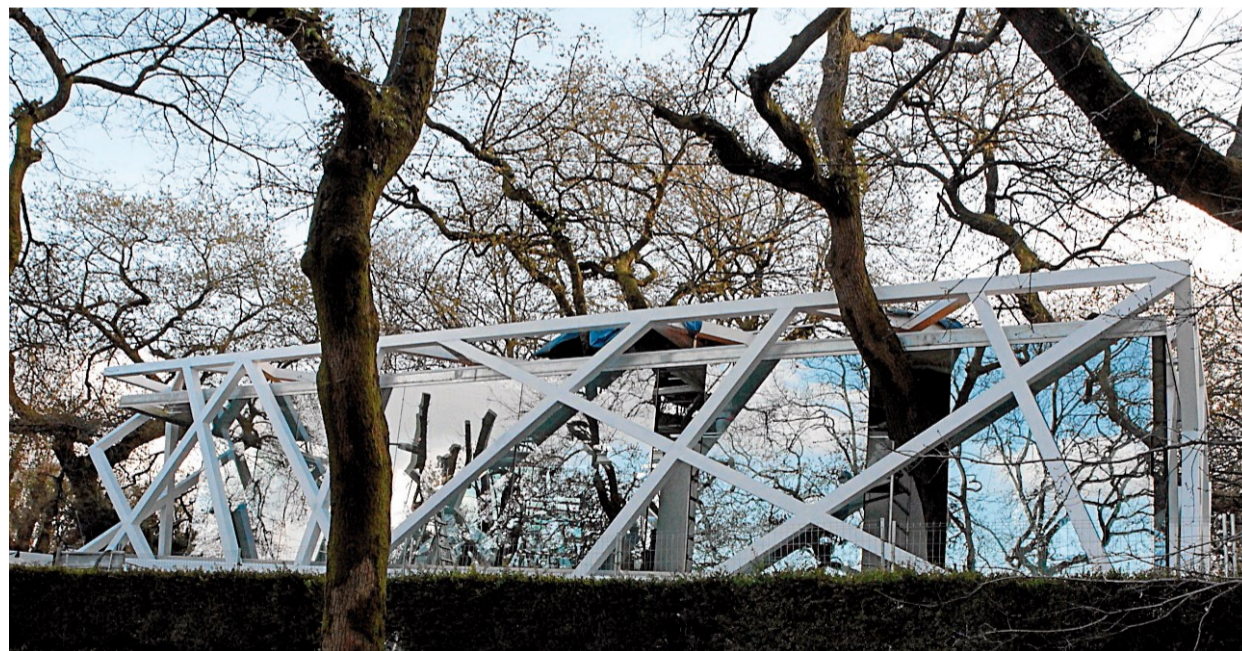
Estado en el que se encuentran las obras de la nueva cafetería de la Alameda de Santiago. Foto: Ramón Escuredo
