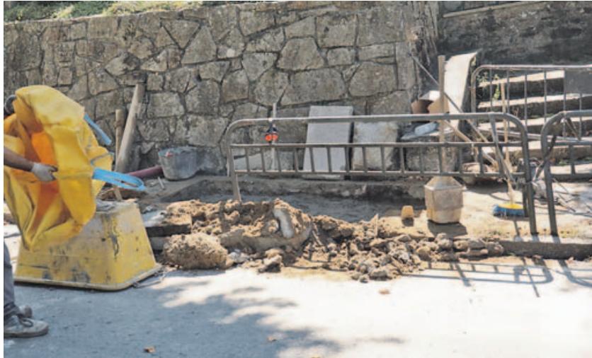
La reparación de la red de suministro obligó a cerrar al tráfico uno de los carriles de subida del vial. SOLER
